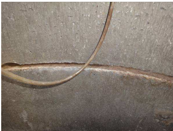
Boring 61.25. Dårlig fugning
