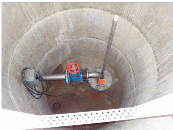
Boring 61.42. Udluftning opadvendt
