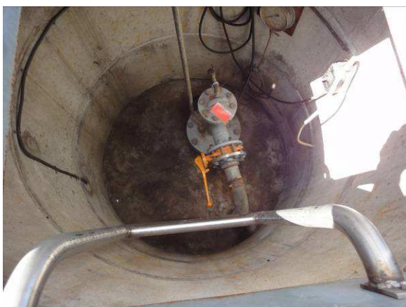
Boring 61.12. Udluftning opadvendt
