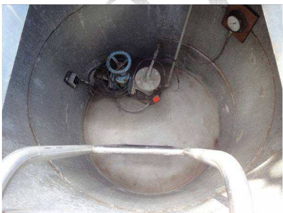
Boring 61.25. Udluftning opadvendt
